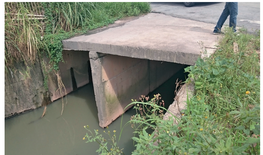
FIGURA 3.2 Imagens do Córrego Itaim nas imediações do quilômetro 19 da Rodovia Raposo Tavares, detalhe da travessia
